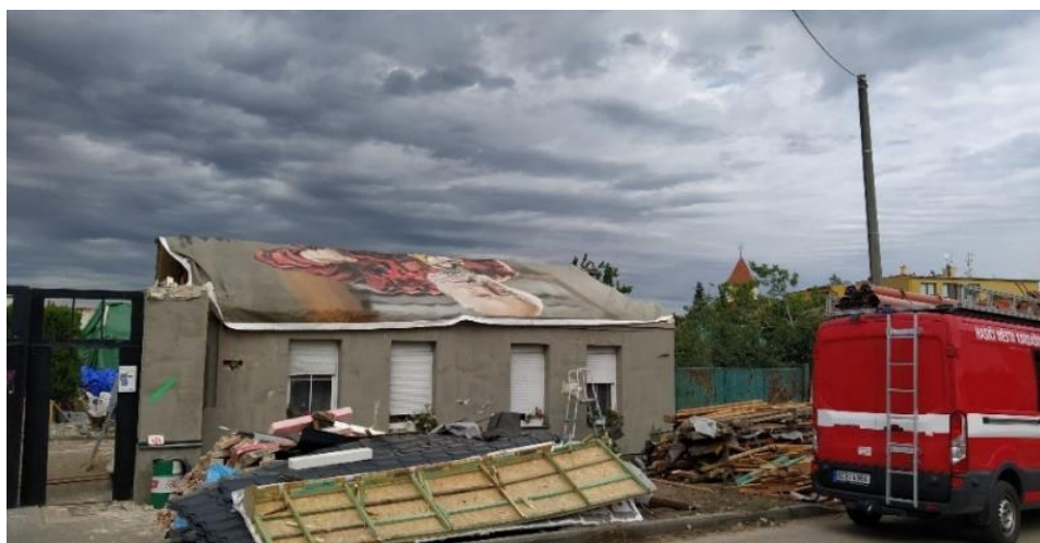
Provizorně zaplachtovaná střecha domu na jižní Moravě (archiv SDH).
